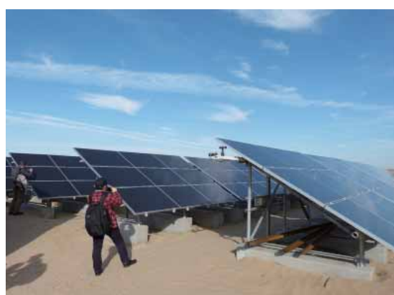
図2 SolarRO システムの施設
